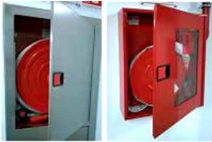
Puertas de BIE de apertura y cierre libre, girando sobre su eje vertical mediante bisagras
