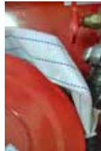
Detalle de BIE de manguera FLEXIBLE PLANA: antes de utilizarla hay que desenrollarla por completo
