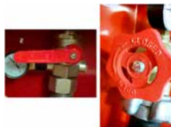
Diferentes modelos de válvulas de apertura del paso de agua desde la red
